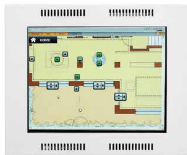
Oltre all'illuminazione e al clima, anche le grate di sicurezza sono integrate nel sistema e sono controllabili tramite touch-screen.
